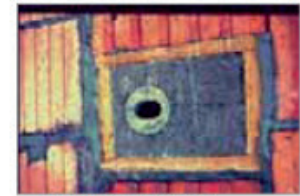
▲ isolation pour éviter la conduction du froid
