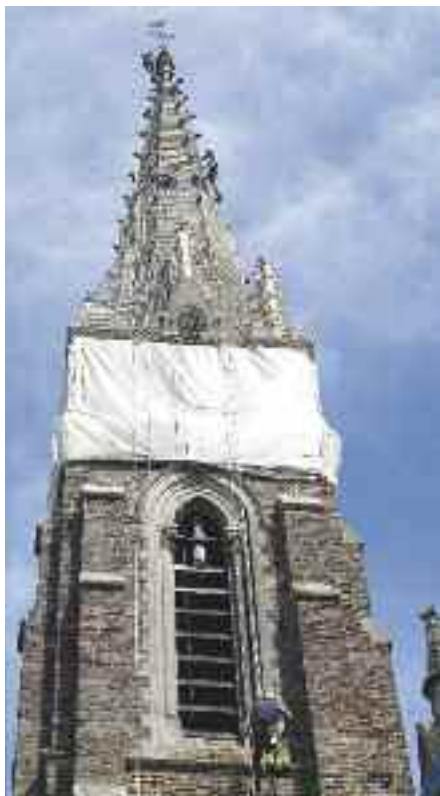
En août 2009, et en attendant sa restauration, le clocher a été mis en protection par la pose d'un filet adapté.
